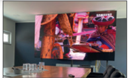
Beispielinstallation: Bolt-Down, Showroom M-Medientechnik / Samsung The Wall
